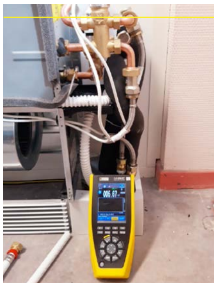
Mätning på värme- och kylaggregat: ström, spänning och temperatur.
