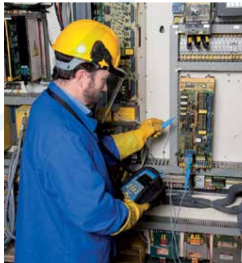
Kontroll av krets kort på en ventilationsutrustning.
